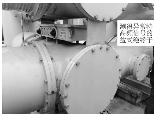
图 22 110 kV 缺陷绝缘拉杆特高频测点
